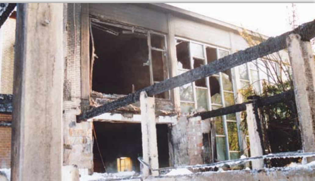
Der völlig zerstörte Anbau vom Fitnessbereich mit Blick auf das stark beschädigte Hallenbad.
